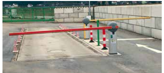
Die Schrankenanlage bei der Anlieferung.
