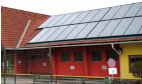
Photovoltaikanlage beim Freibad
